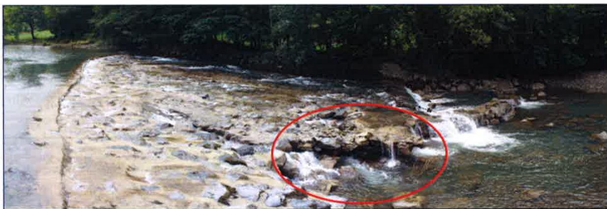
Figure 17 : Photo montrant la zone d'affouillement
